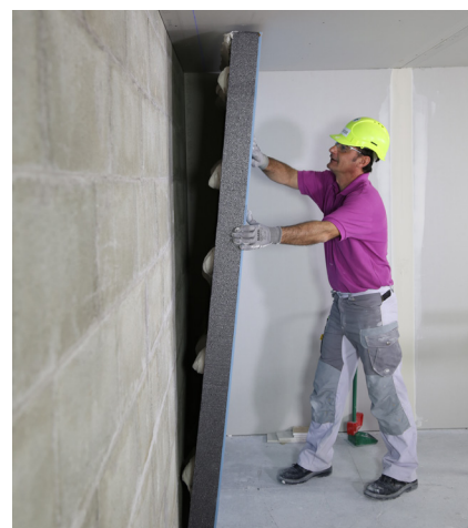
Mise en œuvre du doublage collé PRÉGYMAX 13 + 120 améliorant l'isolation acoustique et thermique des murs.
